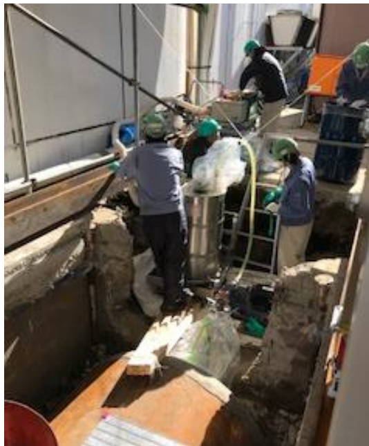
タンク上部からの垂直抜油
