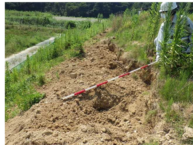
中間貯蔵施設における変状の例 (イノシシ掘返し)
