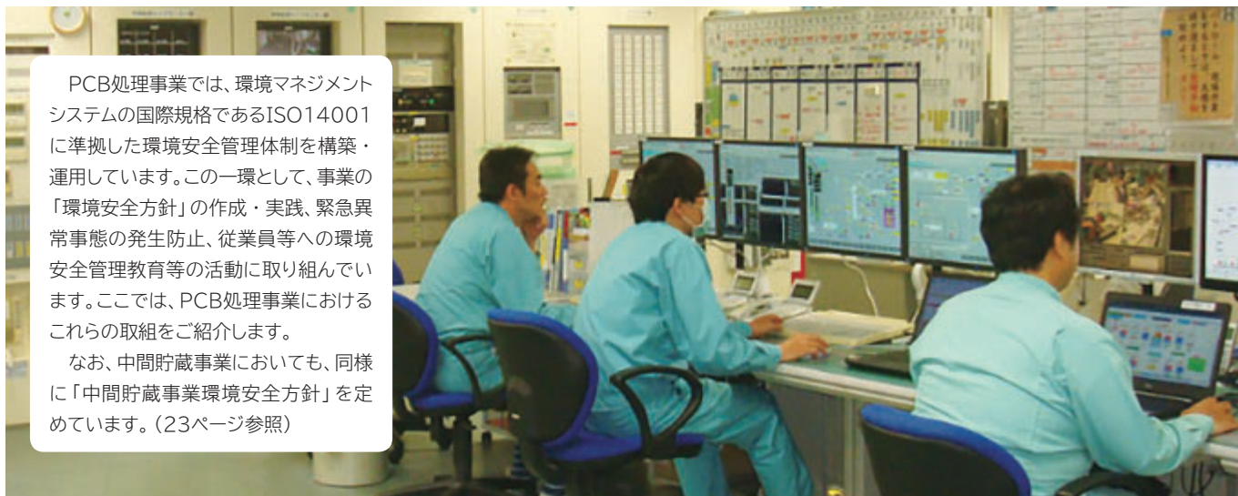
大阪PCB処理事業所中央制御室
