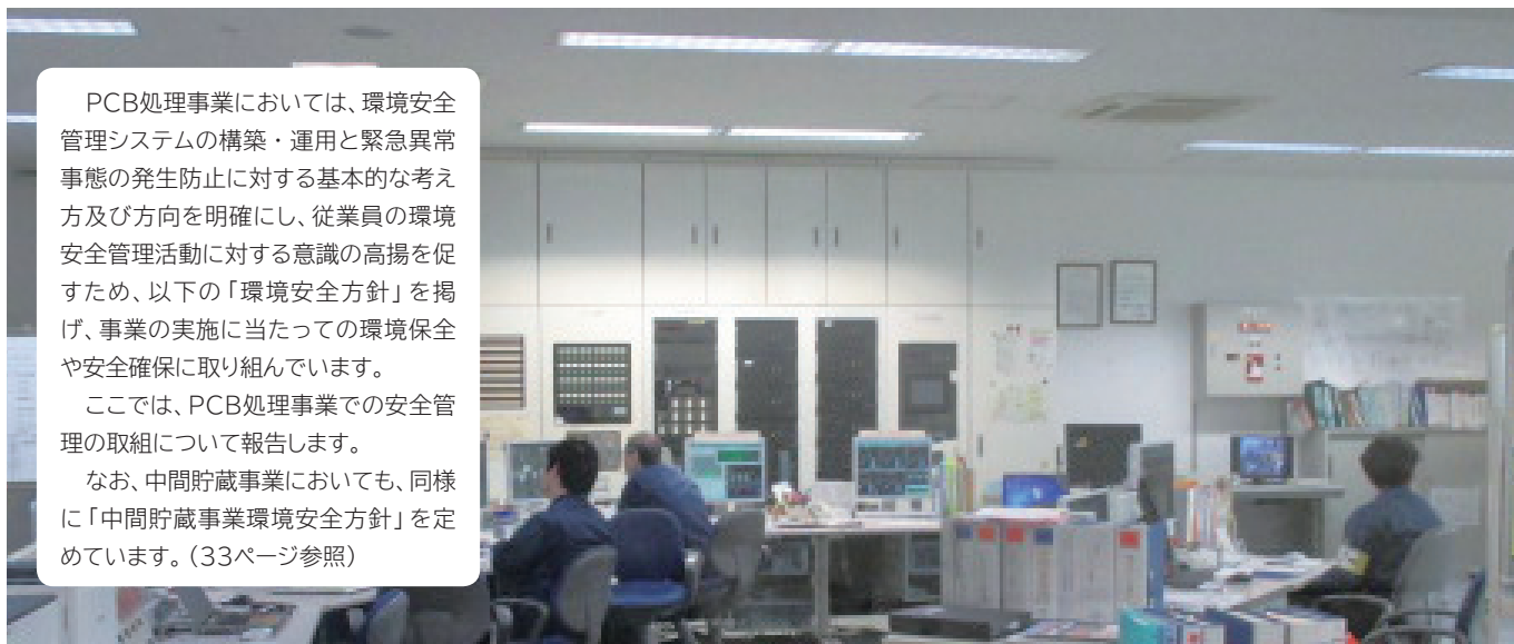
東京PCB処理事業所中央制御室
