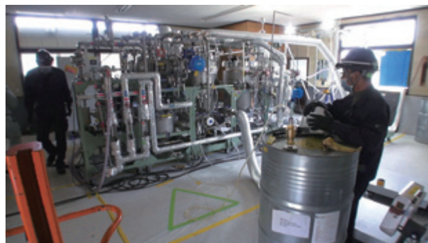
保管事業場における低引火点成分混入PCB油蒸留作業
