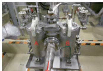
ストレーナの外観 (手前にポンプがある)
