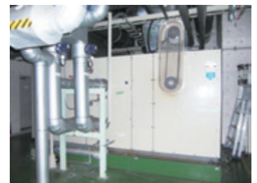
第一外調機の外観
