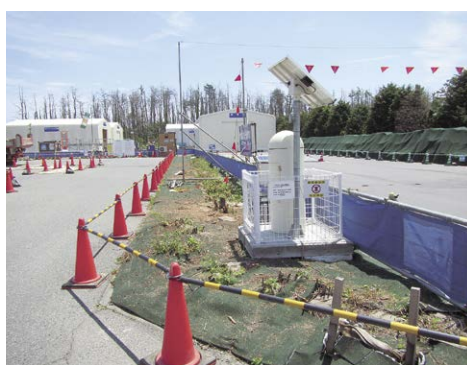
保管場におけるモニタリング装置
