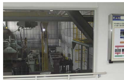
大阪PCB処理事業所 西棟 施設見学ルート真空加熱分離装置(VTR)前
