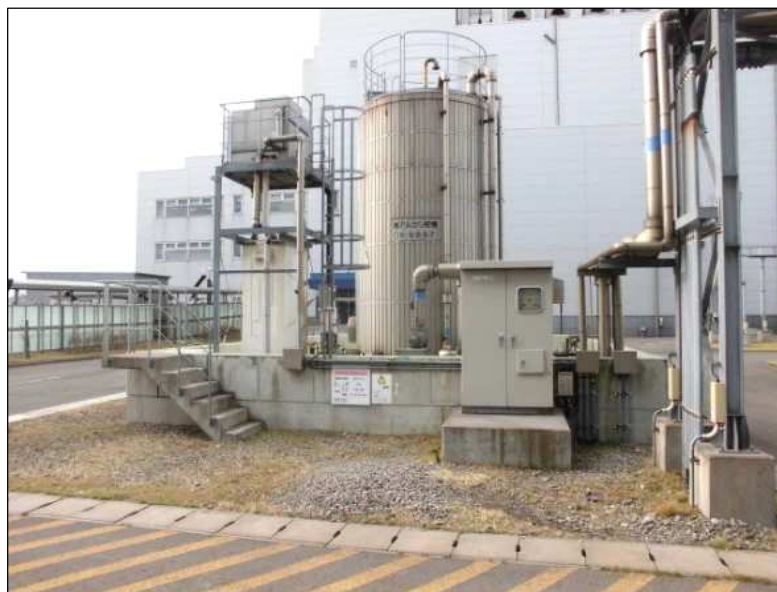
廃アルカリ貯槽 (容量60,000L)屋外構内道路沿いにあり
