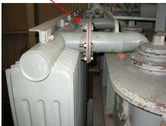
上部継ぎ手切り離し箇所
