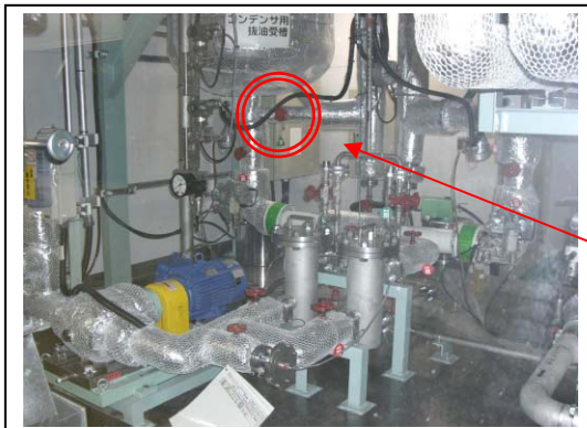
コンデンサ用抜油受槽下部
