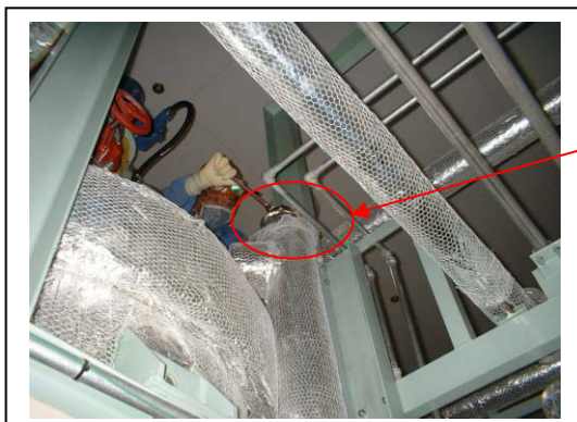
レベル計上部
