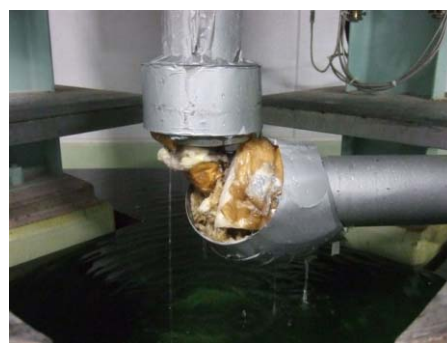
漏洩発生が判明した直後
