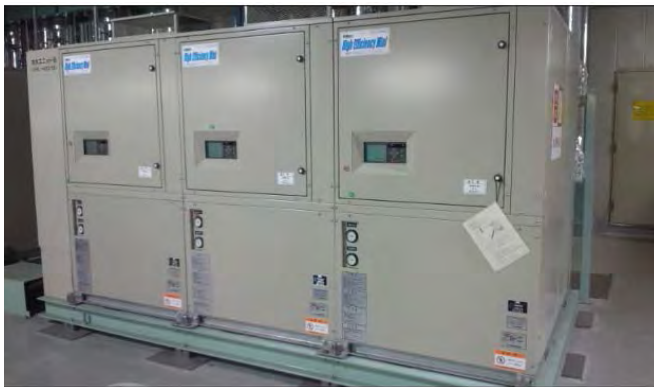
図 冷水ユニットB全体(左から1・2・3号機)
