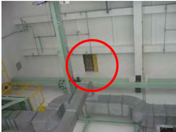
写真1 天井材落下箇所 （天井を下方から撮影）
