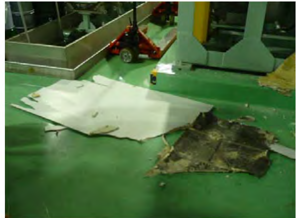
写真2 落下した天井材
