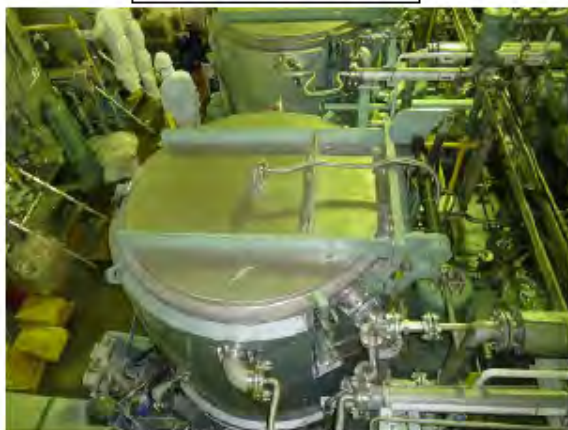
攪拌洗浄槽の外観
