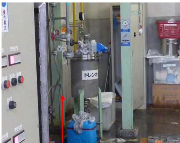
SD剤が漏出した圧抜き配管
