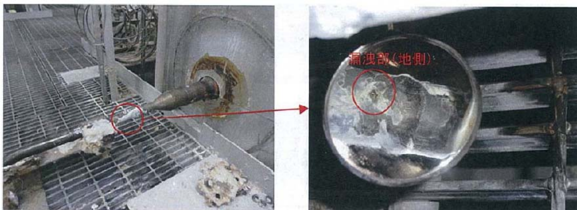
漏洩箇所の写真
