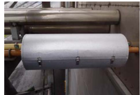
図5 増設施設に設置した鋼製カバー
