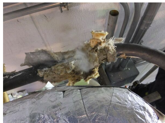
図10 蒸気漏れ箇所(10月)
