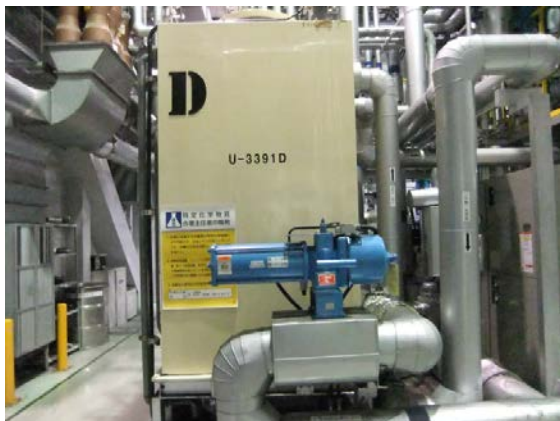
図 20 チラー水タンク
