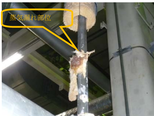
図9 蒸気漏れ箇所(7月)
