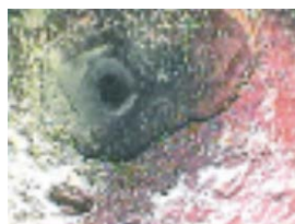
図11 蒸気漏れ箇所 (7月)付近管内面
