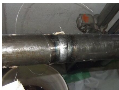
図15 蒸気漏れ箇所(ビード上) (10月)
