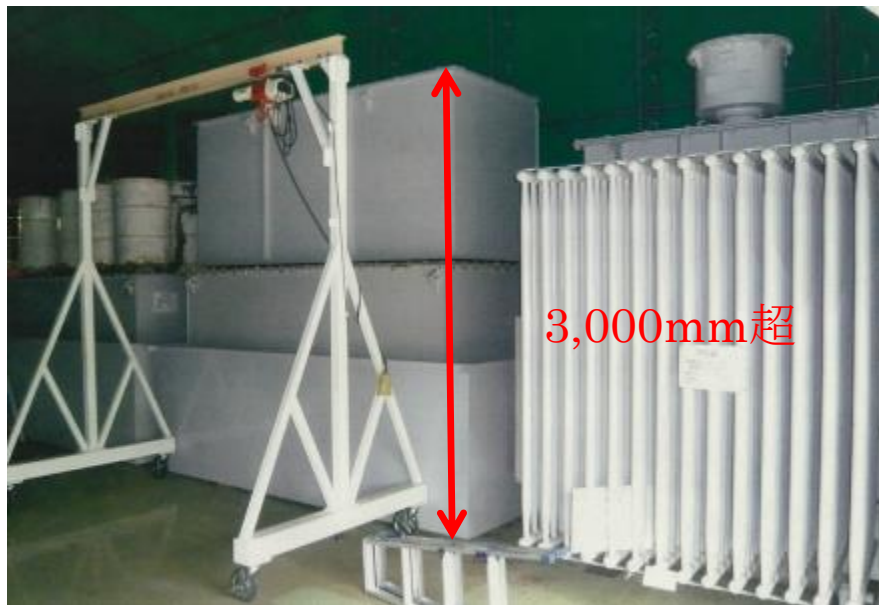
大型PCBタンク
