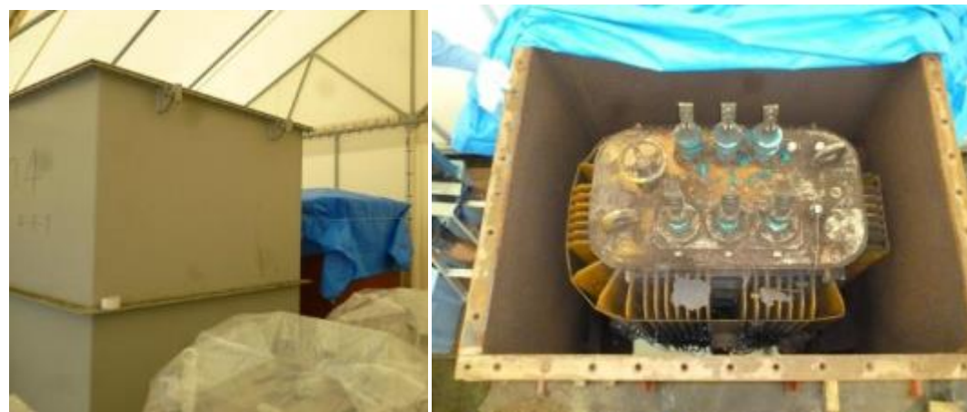
漏洩変圧器が保管された大型容器
