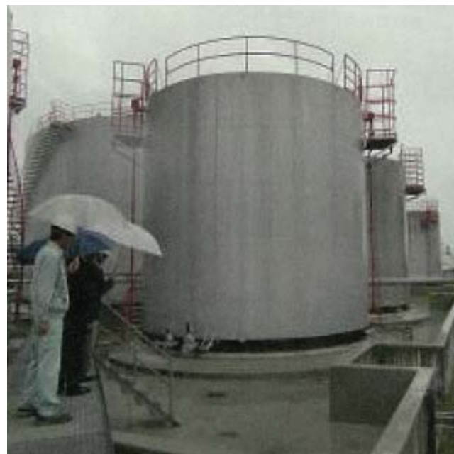
300m 3 ・約60tタンク
