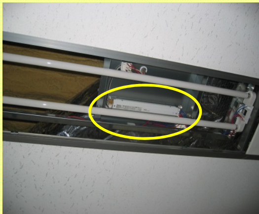
器具内に古い安定器が 残っている例
