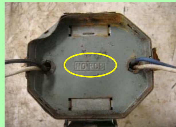
刻印による情報 (「NO PCB」表示→不使用)
