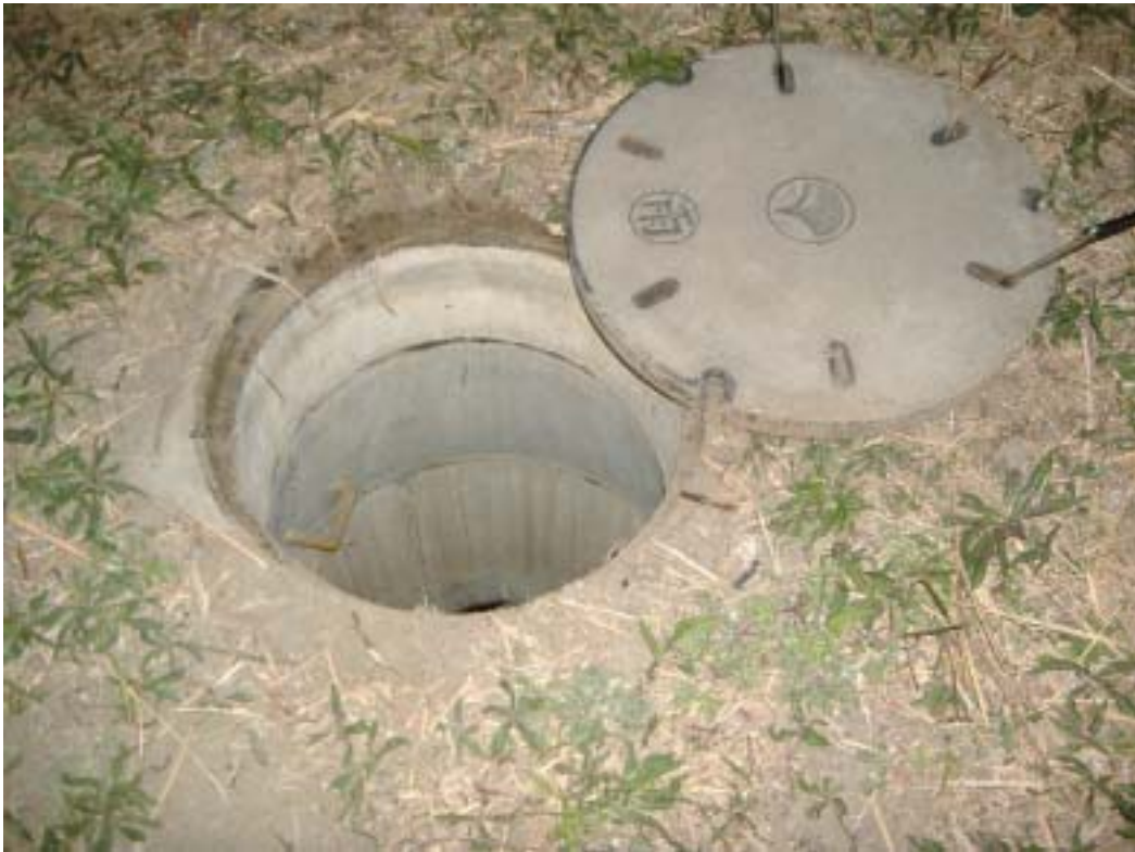
3 . 放流口直近の雨水ます（測定場所 : 3月28日午後7時）
