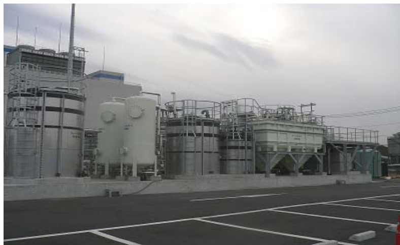
排水処理施設全景
