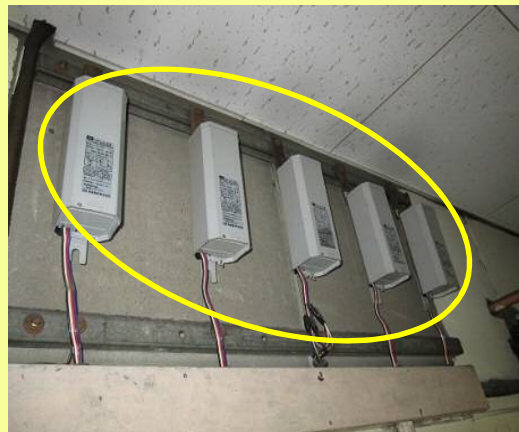
工場等の壁際に設置されてい る複数の安定器の例
