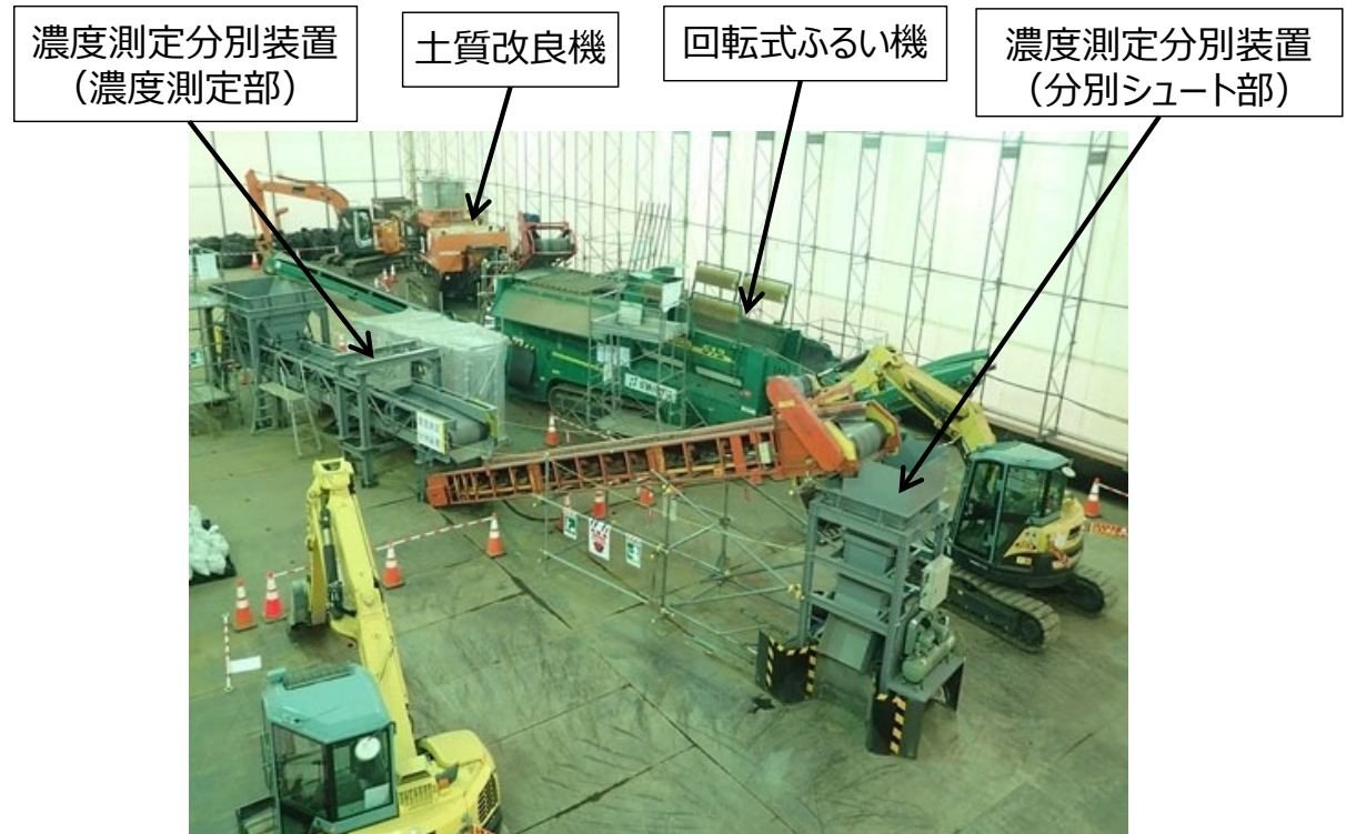
テント内の機器配置（濃度測定分別試験時）
