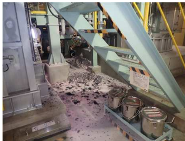
出滓バーナー用送風機蛇腹ホース落下現場状況
