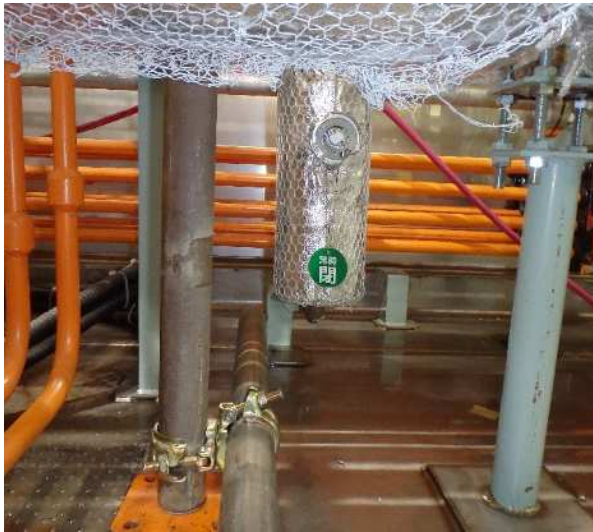
排水ポンプ吐出配管
