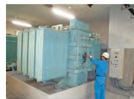
超大型変圧器 (処理が難しい機器の例)
