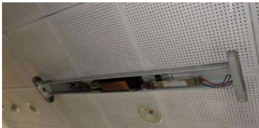
LED化照明器具内部（本体は未交換）
