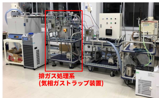
図 2-3 排ガス処理系（気相ガストラップ装置）を増設した改良版ガラス固化装置
