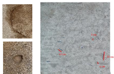
図 3-4 模擬施設で作成した異常識別項目例（亀裂・穴）
