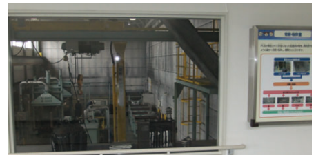
西棟見学コース 真空加熱分離装置(VTR)
