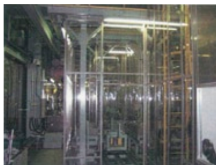
蓋切断装置に設置したフード内フード(北海道事業所)
