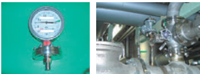
豊田事業所事故で脱落した圧力計
