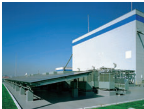
東京PCB廃棄物処理施設の太陽光発電設備
