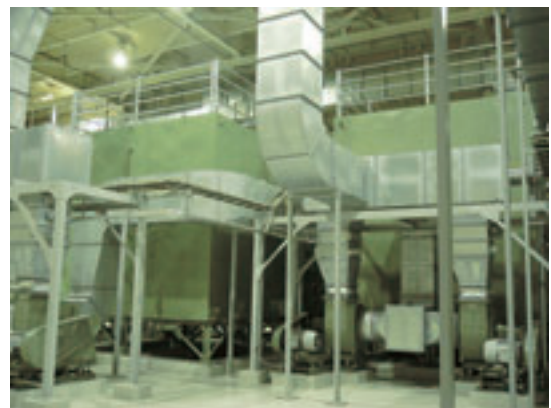
活性炭吸着槽
