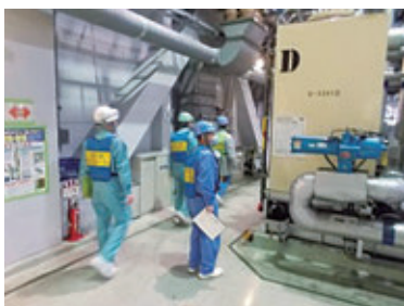
処理施設の設備点検
