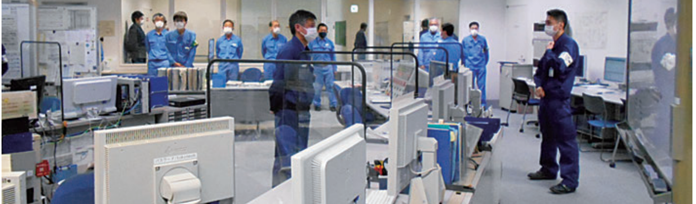
東京PCB処理事業所中央制御室
