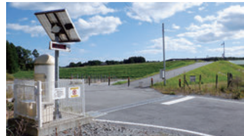
放射線モニタリング装置の設置状況
