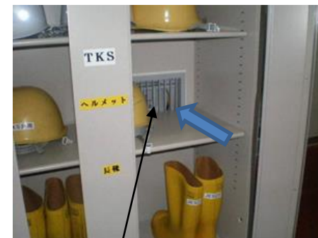
保管庫内にダンパー設置
