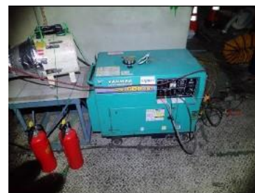
電源確保のための発電機の設置
