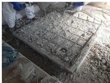
コンクリート中の鉄筋
