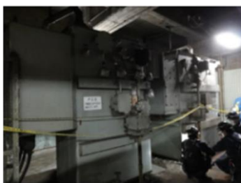
正面(左:変圧器、右側:リアクトル)
