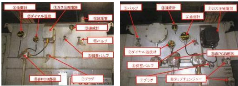
搬出可能寸法とするため取外しが必要な部品類
