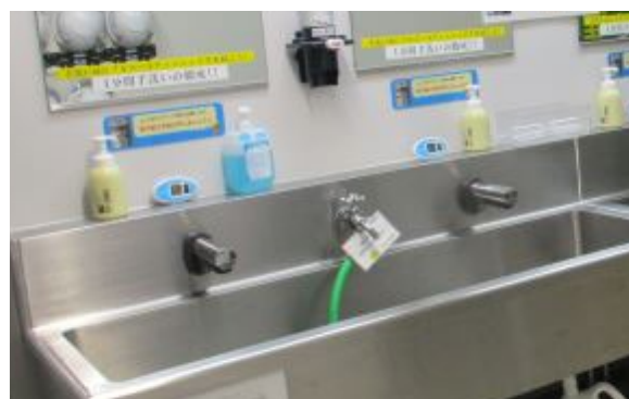
写真 1-13 蛇口からの汚染を防ぐための自動水栓の例（北九州事業所）
