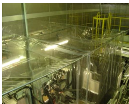
写真 2-1 抜油装置 個別フード
