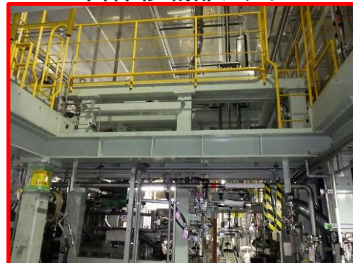
素子取出解体装置 缶体移載部デッキ
