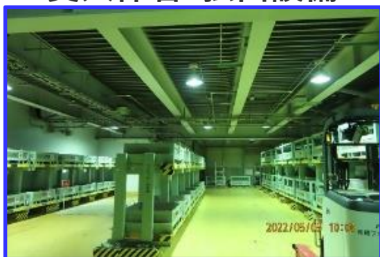
受入保管・払出設備
