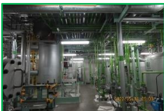
溶剤蒸留回収装置（1～4 FL）
