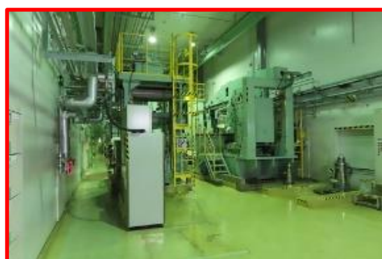
解体分別設備
