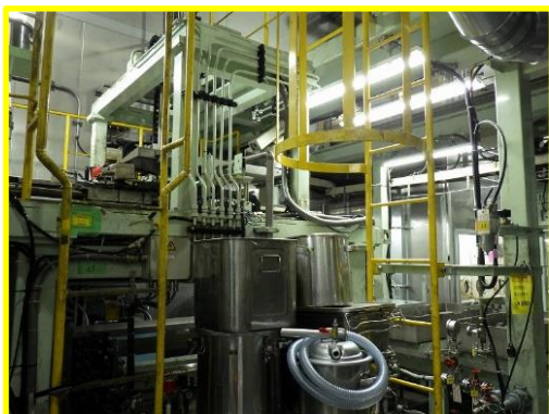
蓋切断装置 蓋切断機
