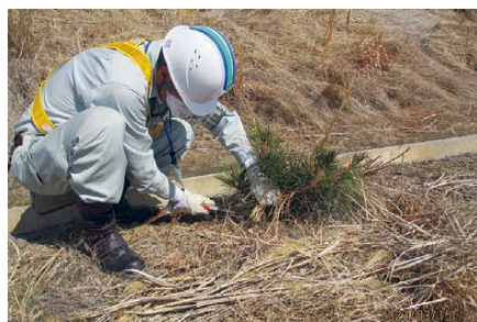
堰堤に生えた樹木の除去
