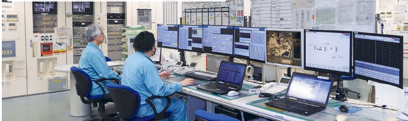
大阪PCB処理事業所西棟中央制御室
