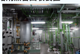
溶剤蒸留回収装置
