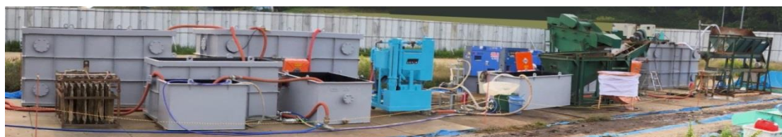
図 3-3 現地試験高圧洗浄システム機器の全体構成
