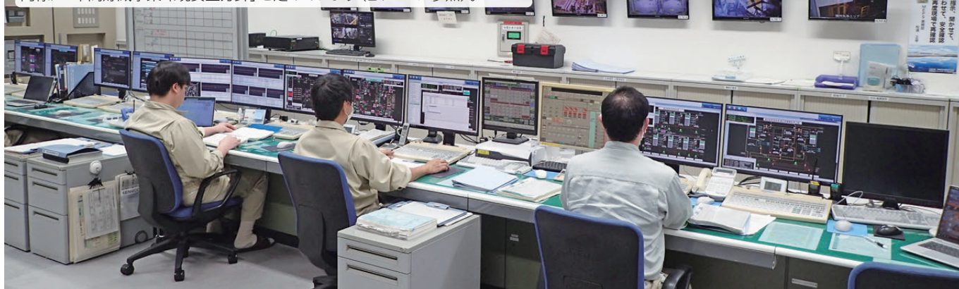
北海道PCB処理事業所当初施設中央制御室
