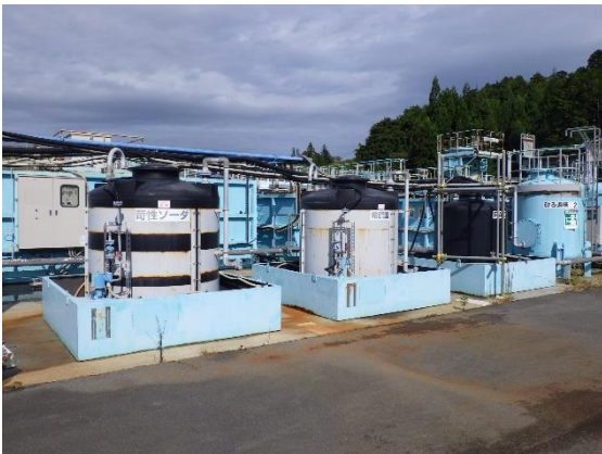
大熊③工区浸出水処理施設
