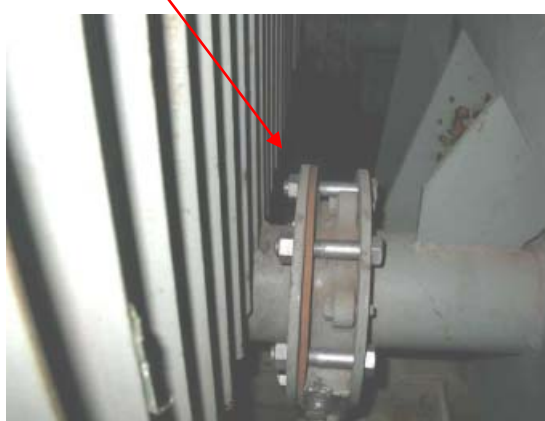
下部継ぎ手切り離し箇所
