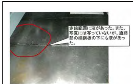
漏洩発見箇所の状況
