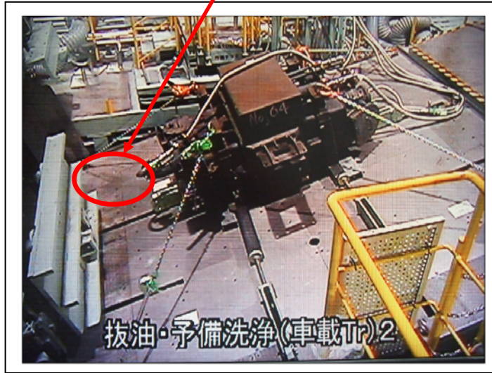
揺動装置 (外観) 通常運転中に車載トランスを +15° 傾斜させたところ
