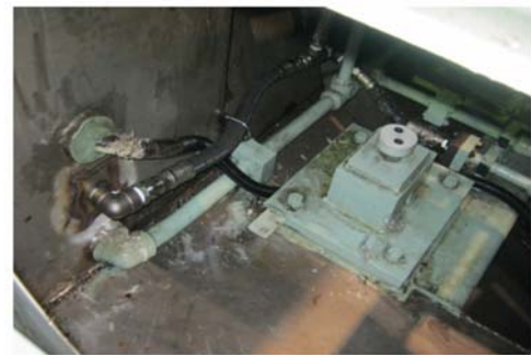
亀裂部・接触部・ストッパー(工事後)
