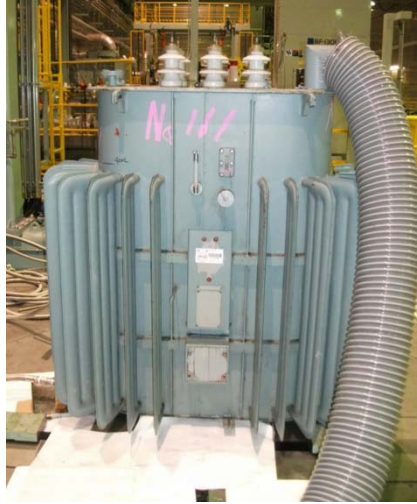
漏洩した大型トランス
