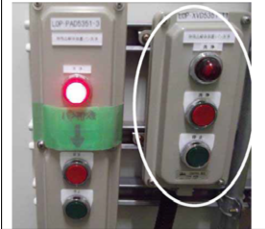
洗浄操作盤（白丸、上から運転中ランプ、 開始ボタン（赤色）、停止ボタン（緑色））
