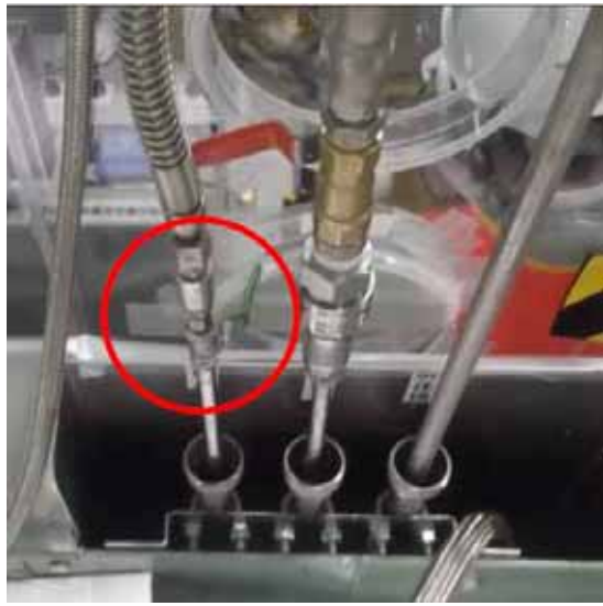
漏洩した給液管（一番左）、鞘管、 ボール弁（赤丸）
