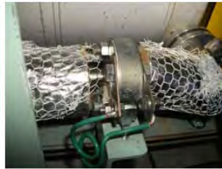
真空ポンプ冷却用給液配管 外観
