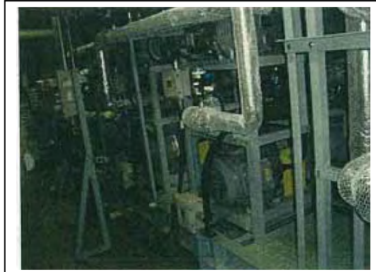
漏洩箇所全体
