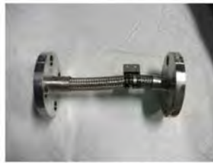
取外し後のフレキシブルホース
