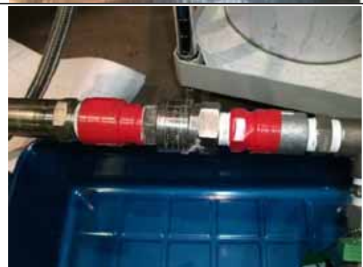
フレキシブルホースの識別 (上:回収用、下:給液用)
