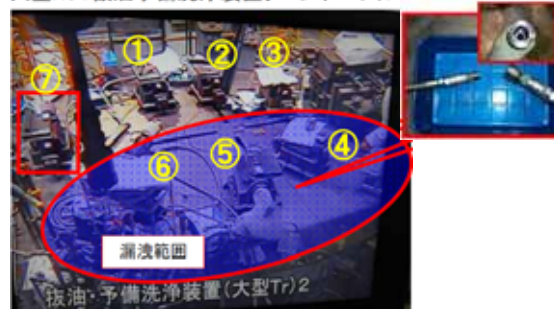
大型No1 抜油予備洗浄装置ターンテーブル
