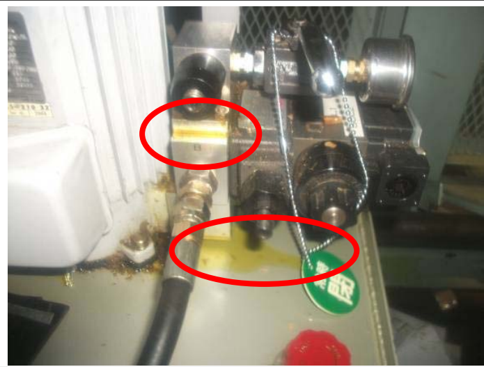
油圧ポンプ起動しての漏洩箇所確認 (ポンプ内部にある接続部から漏洩し、 すき間を伝わってしみ出てきている。)
