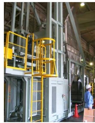
減容圧縮機全体
