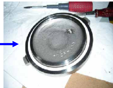
ST-A 蓋裏面⇒異常なし
