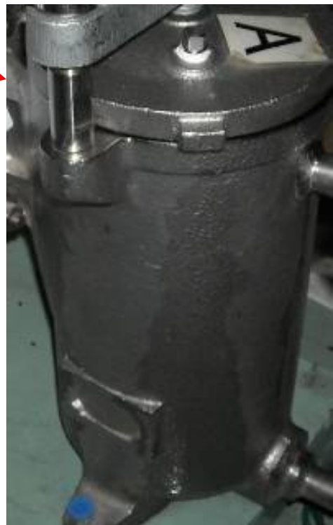
ST-A 蓋部からの漏洩状況
