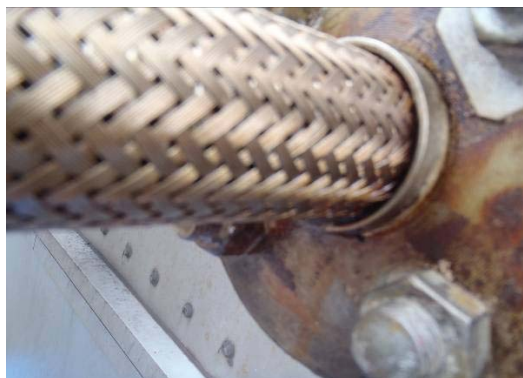
フレキシブルホース (漏洩箇所)
