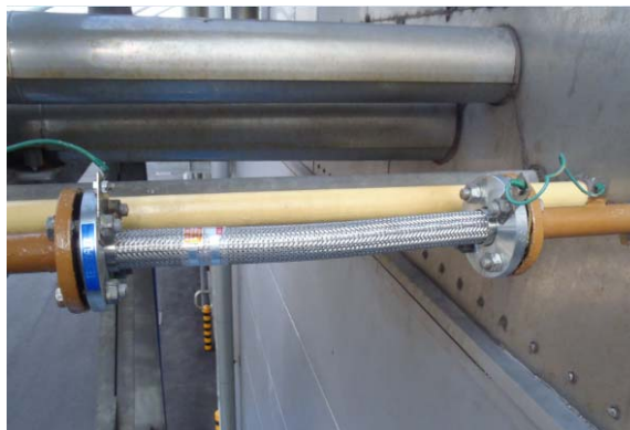
フレキシブルホース (交換後)
