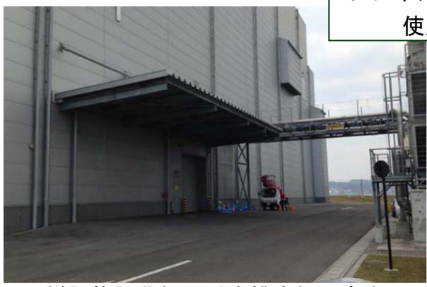
増設施設北側と受水排水処理室を つなぐ空中配管
