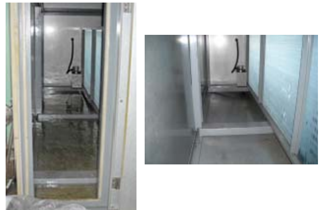
ファンコイル内部 (左: 漏洩時、右: 回収後)
