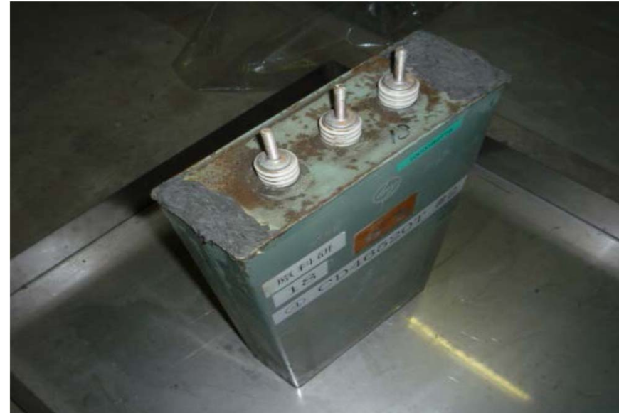
漏れ・滲みのあるコンデンサの補修事例
