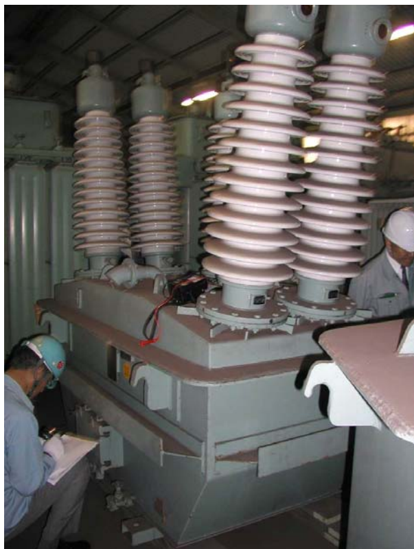
図 10 大型計器用変流器例
