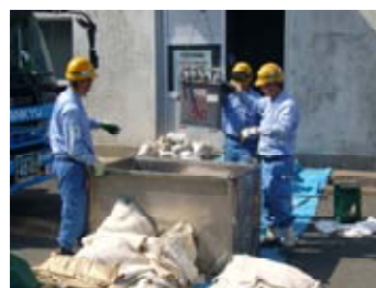
コンデンサの銘板確認 バーコード読み取り 漏れ防止型金属トレイ に積み込み
